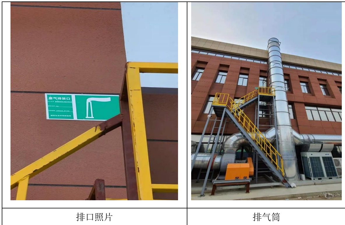
图 4.2-1 PQ-1 排气筒照片
